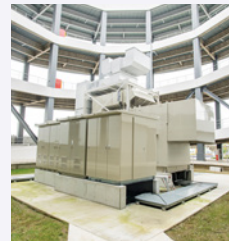
自家発電設備
